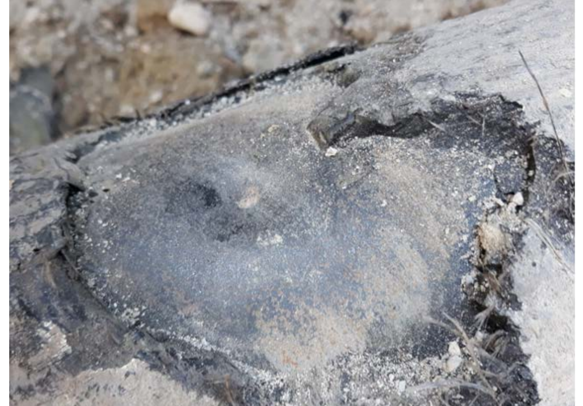
Fig. 15 - Il danno provocato dal picchetto sulla rete gas.
